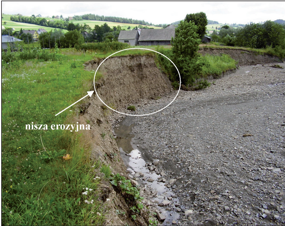
Fotografia 4.1. Fragment koryta sekcji A 2 po wezbraniu z dnia 29-30.06.2006 r. Figure 4.1. Stream channel after the raised water level on 29 and 30/06/2006 (section A 2 )
