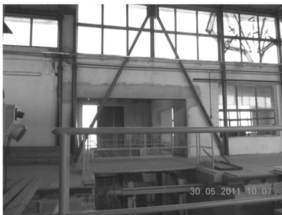
Rys. 14. Konstrukcja wsporcza z zastrzałów rurowych w miejscu likwidacji istniejącego słupa hali, aby możliwe było wykonanie zapadni kolejowej
