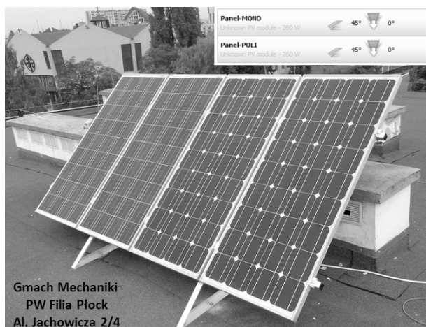
Rys. 2. Fotografia minisystemu PV – „Politechnika-Płock” Fig. 2. Minisystem PV Photography – „Politechnika-Płock”
