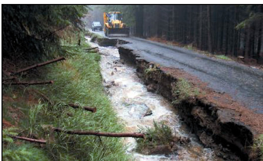
Fot. 3. Jedna z wielu uszkodzonych dróg asfaltowych w Nadleśnictwie Świeradów (fot. A. Alchimowicz) Photo 3. One of many damaged asphalt roads in the Świeradów Forest District
