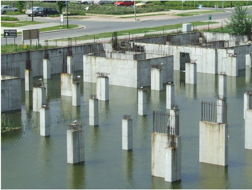
Fot. 3. Opuszczona budowa zasiedlona przez śmieszkę Larus ridibundus . Warszawa-Wilanów, 29 V 2010 r. (fot. D. Sikora)
