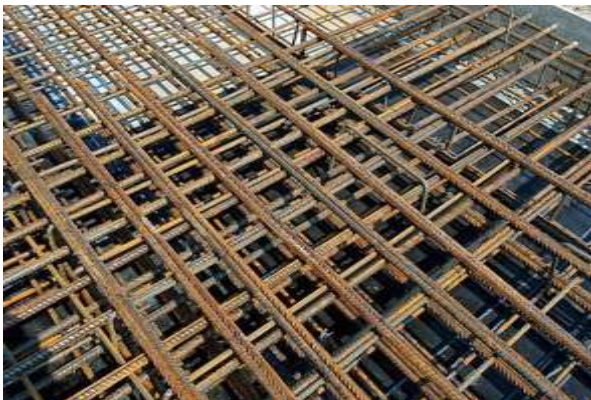
Рис. 6 – Высокий коэффициент армирования в определенных зонах конструкций Fig. 6 - High reinforcement ratio in certain areas of structures
