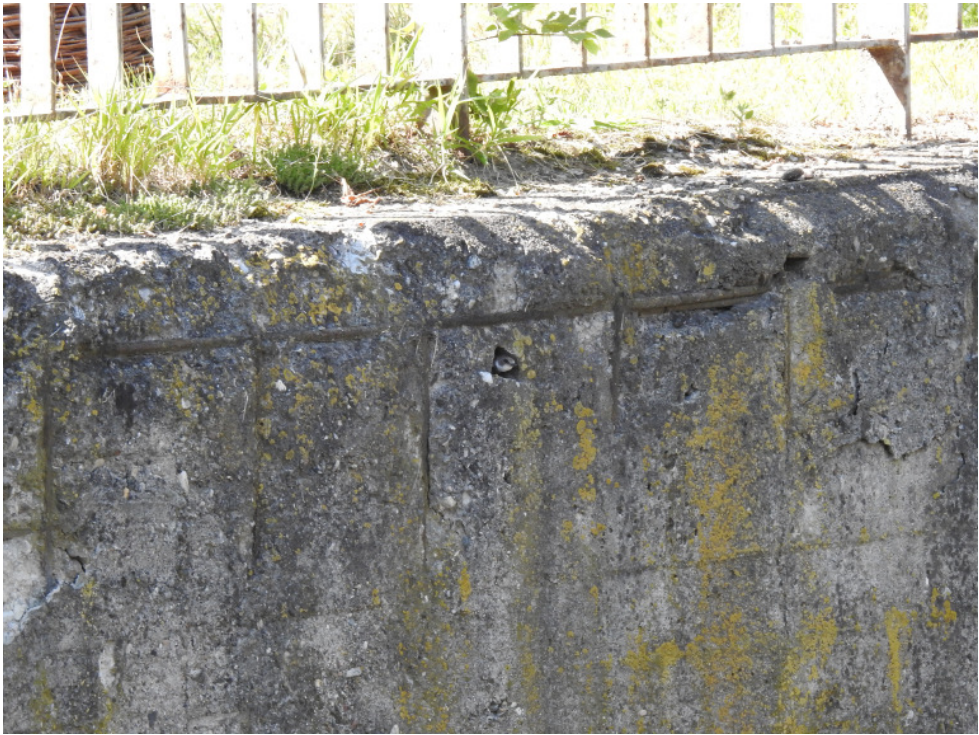
Fot. Zajęta przez brzegówkę Riparia riparia szczelina w betonowej ścianie, 6 VIII 2020 r. (fot. K. Mortka)
