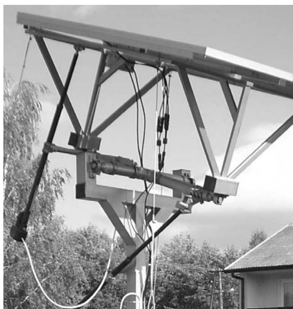
Rys. 1. Fotografia stanowiska badawczego Fig. 1. Image of the test stand
