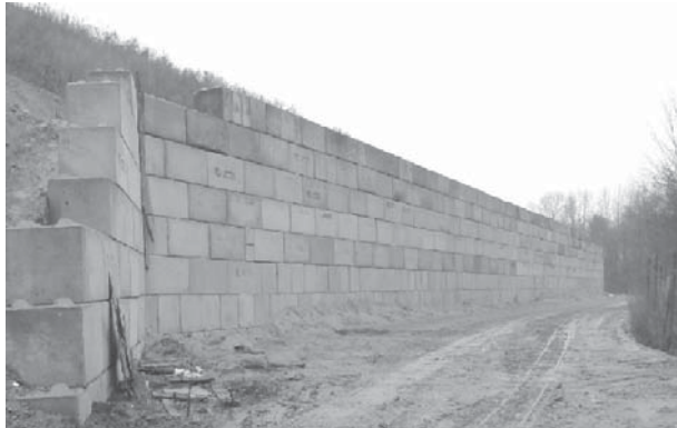
Rys. 3. Widok muru oporowego od strony południowo-wschodniej Fig. 3. A view of a retaining structure on the south-east
