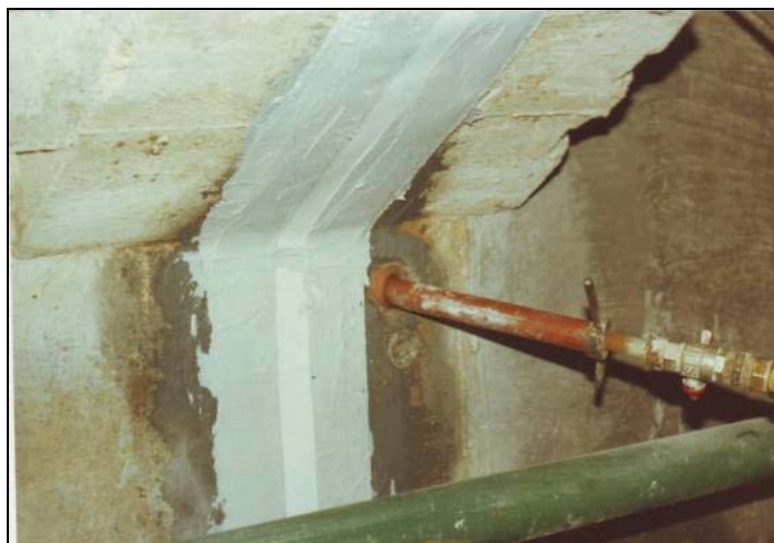
Rysunek 1. Jaz Janowice. Taśma elastyczna i doszczelnienie betonów metodą iniekcji ciśnieniowej (stan 2006 r.)
