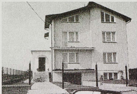
Rys. 6. Wystające płyty balkonowe w budynku mieszkalnym z lat osiemdziesiątych XX wieku w Strzelnie na Kaszubach, lipiec 2002 (fot. autor)
