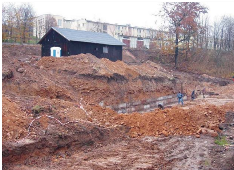
Fot. 4. Teren obok budynku Nadleśnictwa Świeradów, na którym powstanie „małe torfowisko izerskie” (fot. Z. Czajka) Photo 4. Land next to the Forest Division Świeradów building, where a „small Izera bog” will be created
