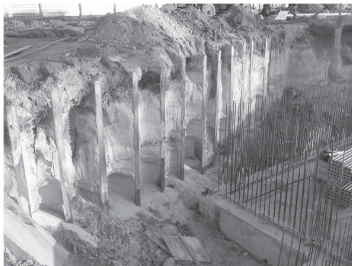
RYSUNEK 2. Widok przesłony podpartej dwuteownikami FIGURE 2. The view of cut-off wall supported with T-beam
