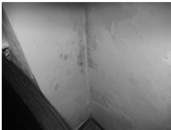
RYSUNEK 7. Zawilgocenie muru pomieszczeń przyziemia pałacu FIGURE 7. Water damage of the wall of the palace basement rooms
