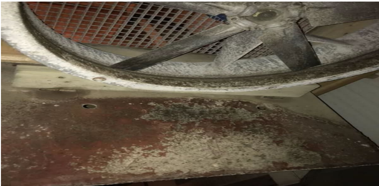
Fot. 2. Wentylator i jego drewniana osłona odwróconego przepływu powietrza ze złożami stosowanego w przeszłości chlorprofamu (foto: PVC)
