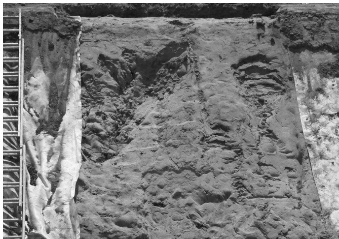
Rys. 8. Widok erozyjnej destrukcji skarpy zbiornika i wyłobień z lokalnymi splywami i usuwiskami gruntu (stan po odpompowaniu wody, 24.07.2012)
