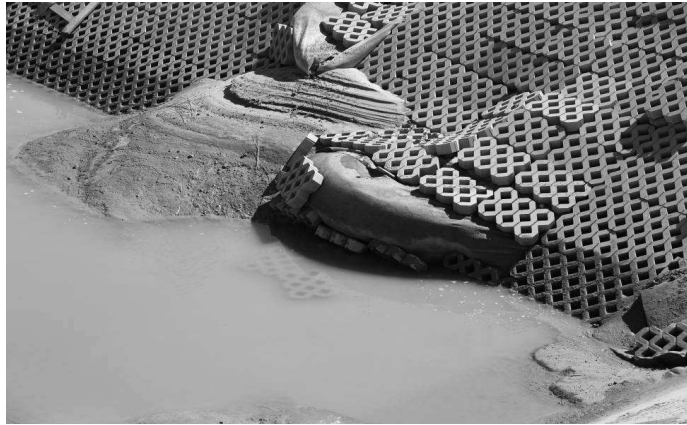
Rys. 7. Widok zniszczeń zbiornika – sływ gruntu wraz z płytami, naruszenie geowłókniny, stożki napływe na dnie zbiornika (stan po odpompowaniu wody, 24.07.2012)
