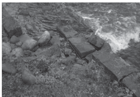
RYSUNEK 9. Destabilizacja bloków betonowych na końcu wypadu jazu FIGURE 9. Destabilization of blocks on the end of stilling basin
