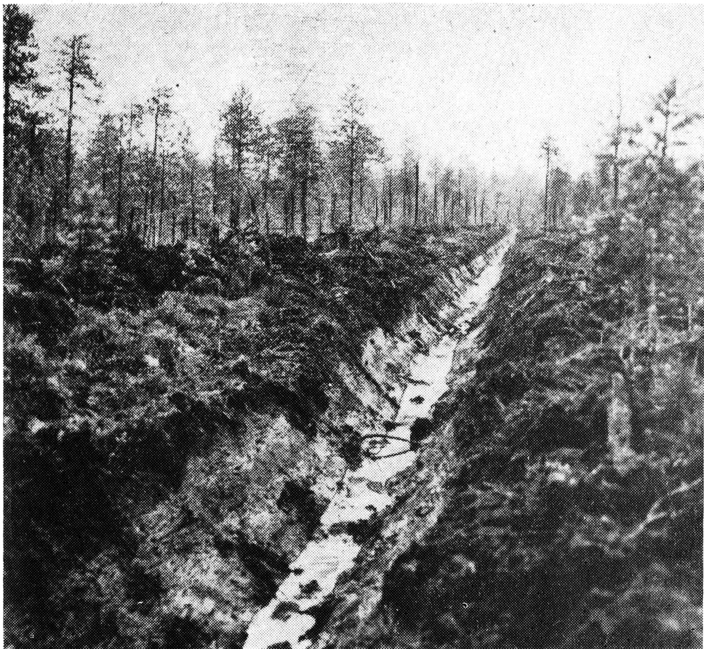
Fot. 4. Rów melioracyjny na torfowisku wykonany za pomocą koparki hydraulicznej zamontowanej na ciągniku rolniczym
