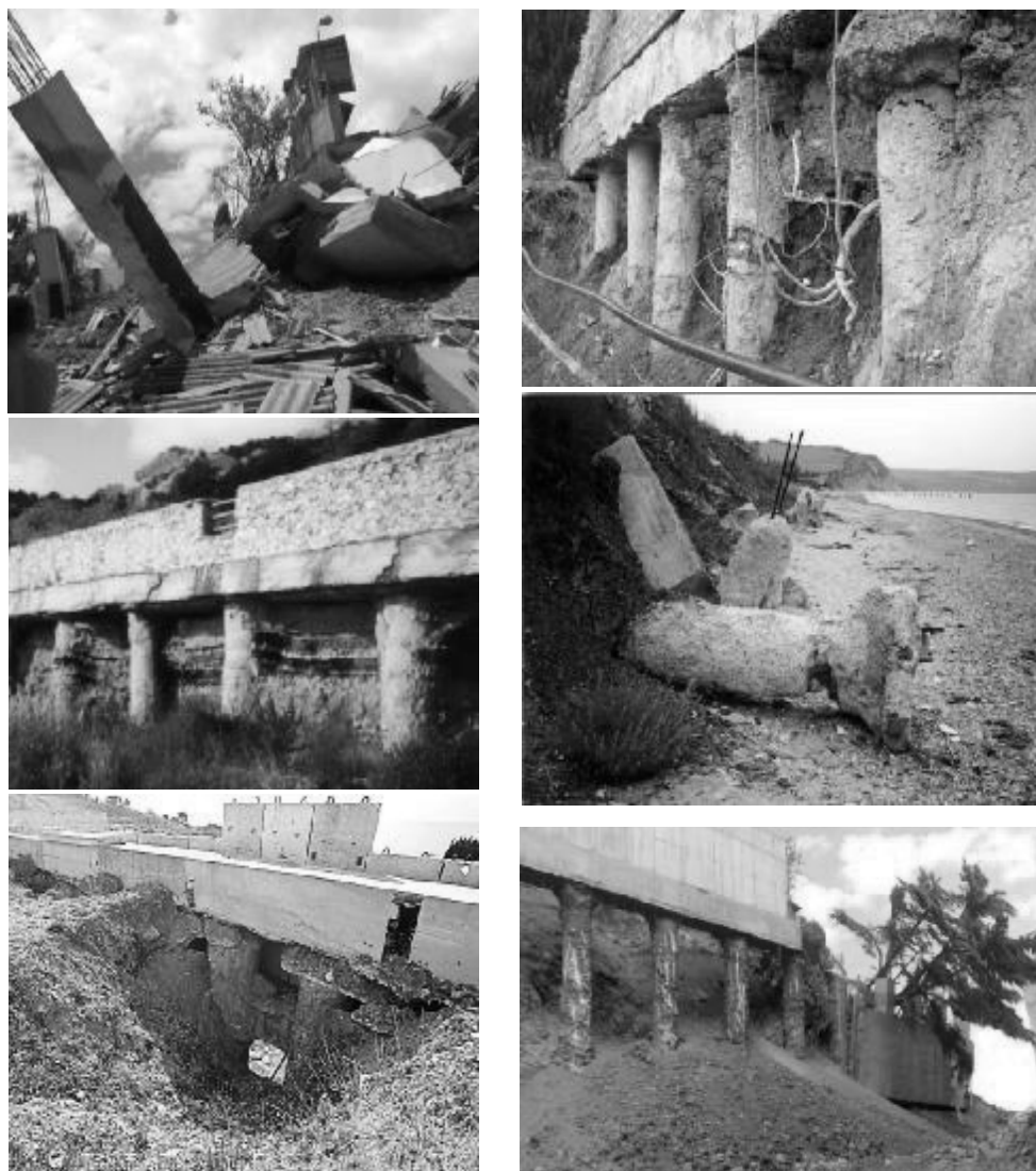
Рис.1. Повреждения системы «массив грунта – удерживающее сооружение – основание» Fig. 1. Damage to the system, "an array of ground - retention structure - foundation"
