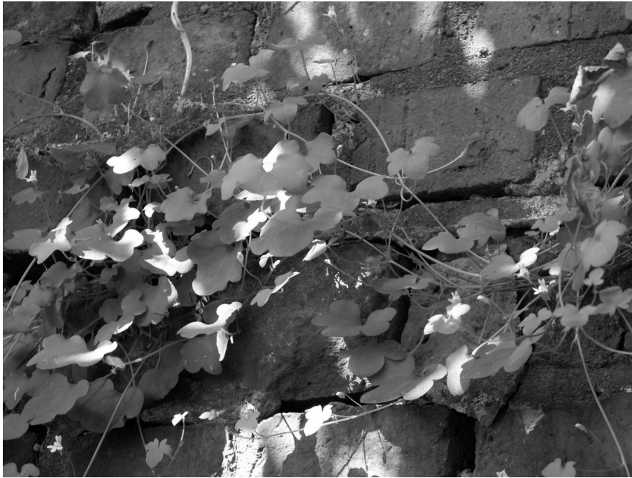
Phot. 2. The plants of Cymbalaria muralis on the basic part of the wall (photo by S. Janyszek) Ryc. 2. Okazy Cymbalaria muralis porastające dolną część ściany klasztoru (fot. S. Janyszek)
