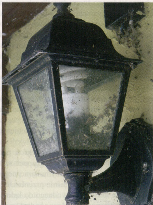
Ryc. 1. Zanieczyszczona owadami lampa zewnętrzna. Fot. M. Urbańska.
