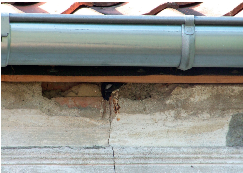
Fot. 2. Gniazdo oknówki w szczelinie budynku (fot. M. Bebłot) – Nest of House Martin in slit of building
