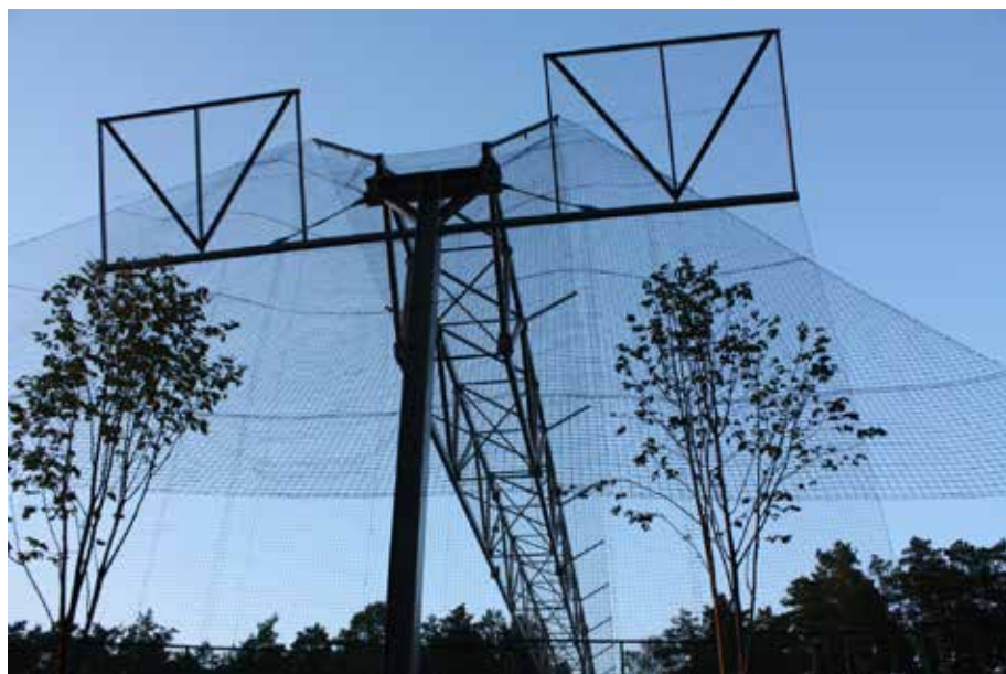
Ryc. 2. Bramownica zlokalizowana przy autostradzie A-2 w okolicach Lubrzy
