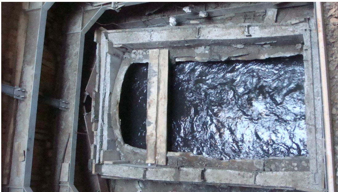
Рис. 6. Состояние коллектора после демонтажа тубингов
