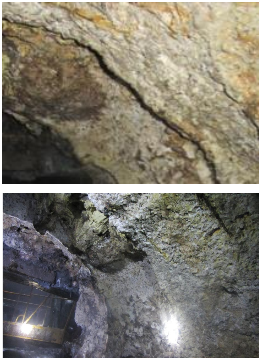
Рис. 2. Внутренняя поверхность канализационных тоннельных коллекторов, разрушенная коррозией
