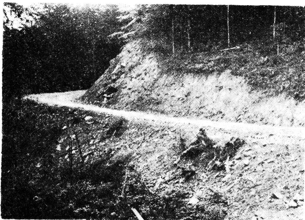
Ryc. 2. Fragment odcinka badawczego dróg stokowych. Droga w ostrych łukach, skarpy wykopów częściowo plantowane
