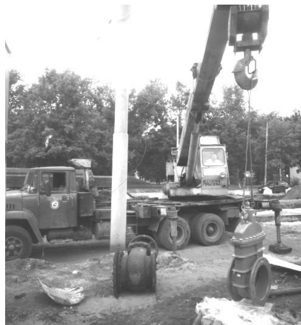
Рис. 15. Замена технически изношенной чугунной задвижки на задвижку с обрезиненным клином Fig. 15. Replacing technically worn iron gate bolted with rubber-wedge
