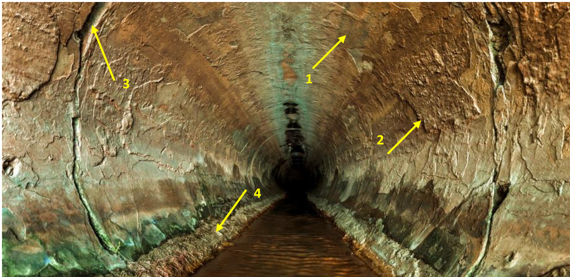
Рис. 1. Характерные повреждения железобетонных трубопроводов
